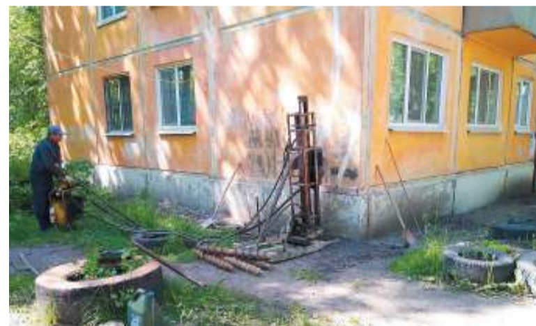
При помощи этой бурильной установки методом инъектирования (заливки раствора под давлением) были сделаны сваи, чтобы предотвратить проседание фундамента
