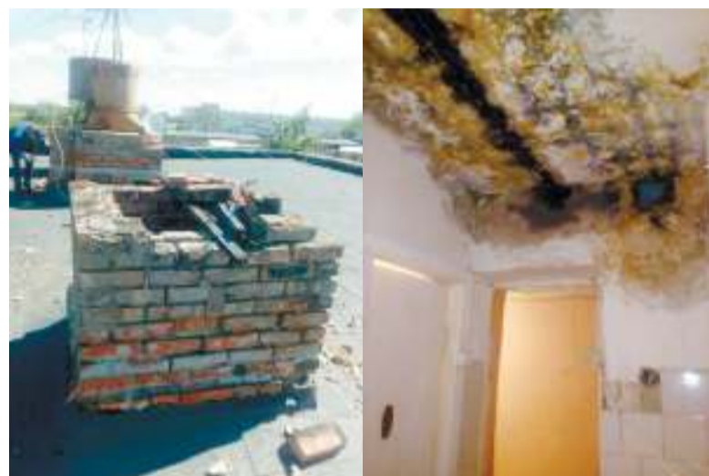
На крыше дома - бардак, ДВК разрушены, как следствие - потолки сгнили от протечек
