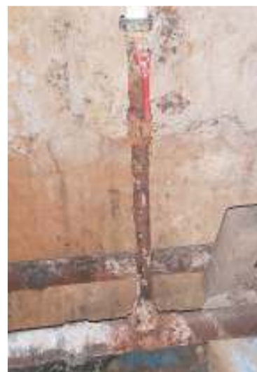
В подъездах - новенькие лифты, в подвале - гнилые трубы, на счету огромный долг за капремонт
