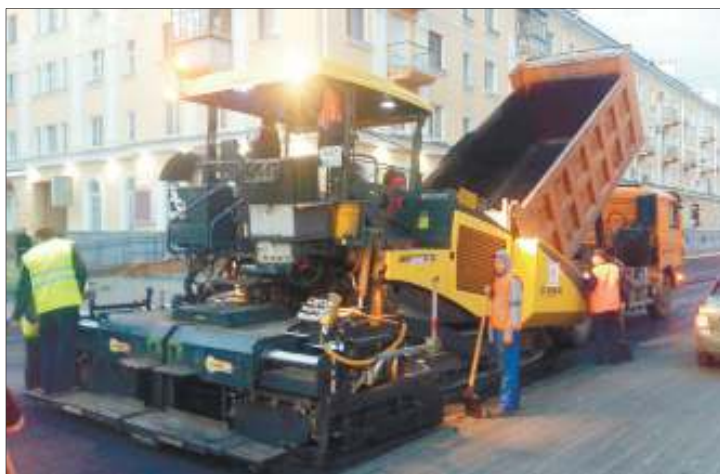
На ул. Карла Маркса идут работы по укладке нижнего выравнивающего слоя асфальта
