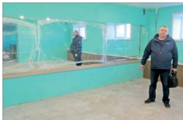
Владимир ВАСИЛЬЕВ показывает помещение для секции кикбоксинга, где завершается ремонт. Ребята попросили одну стену сделать зеркальной - это нужно для тренировок
