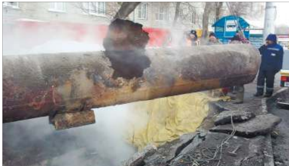
Износ тепловых сетей в Ульяновске (по официальным данным) составляет 62%, или 700 км трубопроводов, которые имеют срок службы более 20 лет
