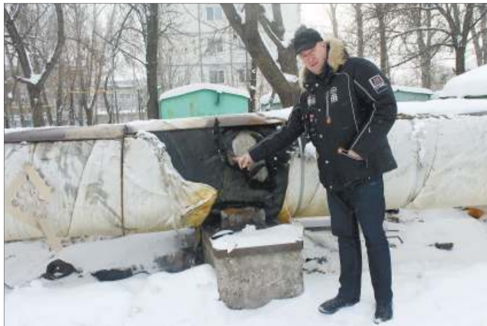
Активисты ОНФ (на фото Алексей СИТНИКОВ) проводили в прошлом году мониторинг «С теплом - труба», который показал, что состояние тепловых сетей в городе оставляет желать лучшего. Большая протяженность изношенных тепловых сетей обуславливает и высокие потери - от 1,73 до 4,77%
